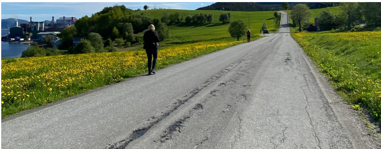
Figur 5 Synlig dekkeskade på fv. 6432 vest for atkomst til anlegget. (Foto: Norconsult, mai 2022)
